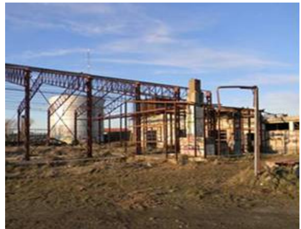
Figura 13 Aquí se observa otra estructura metálica, parte de uno de los galpones presentes en el predio que también pertenecía a YCF. Con el paso de los años y el crecimiento del borde costero hizo que la avenida costanera se extendiera atravesando inclusive uno de esos galpones. Fotografía tomada en 2015. Fuente: elaboración propia
