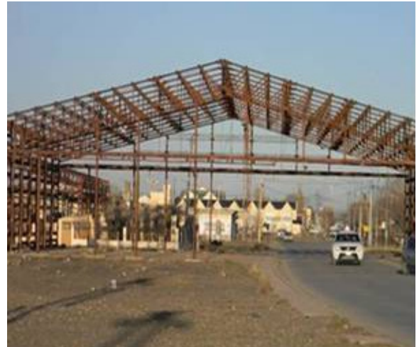
Figura 12 Tomada en el año 2015. Uno de los tantos galpones utilizados por la empresa Estatal Yacimientos carboníferos Fiscales (YCF) que han quedado prácticamente desmantelados, solo la estructura metálica ha quedado lo cual implica un peligro de derrumbe por el mal estado y para las personas que circulan a pie por el lugar
