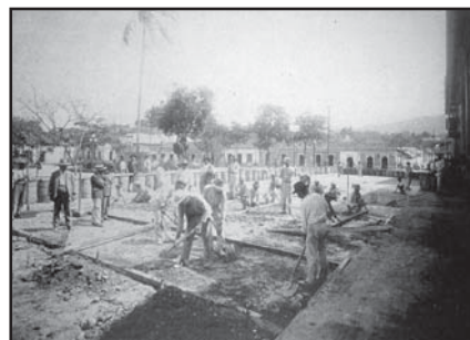
Figura 3. Calle en construcción, Plaza Bolívar de San Cristóbal, 1929. En: Venezuela, Ministerio de Obras Públicas, Memoria 1930, p. CLX, Foto XXI.
